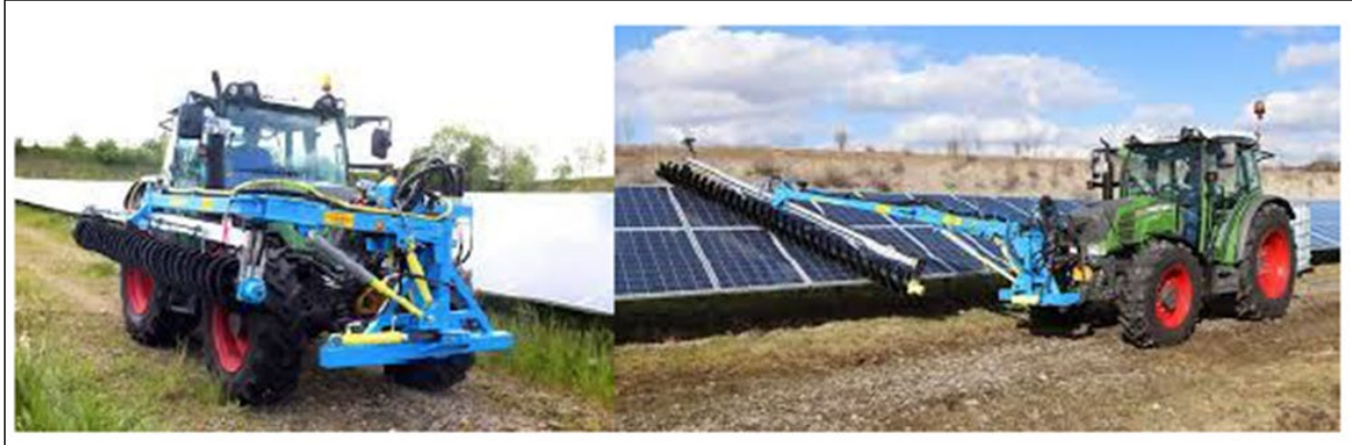
Exemple d'engins utilisés pour le nettoyage des panneaux (Source : Mémoire en réponse à l'avis de la MRAe pour le projet de Taller)
